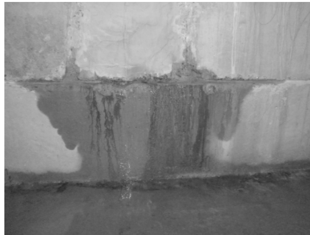
Рис. 9. Нарушение герметичности конструкции в результате повреждения гидроизоляционного слоя
