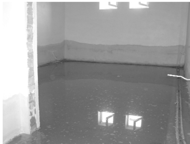
Рис. 5. Отказ работы гидроизоляции из-за изменения водных нагрузок
