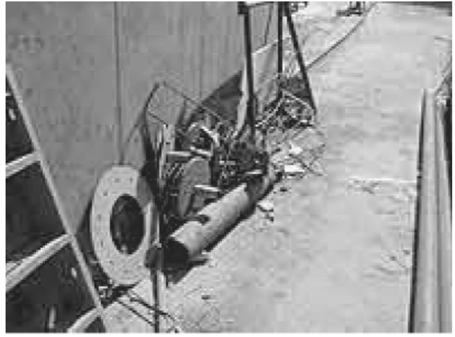
Рис. 7. Повреждение гидроизоляционного слоя в процессе складирования
