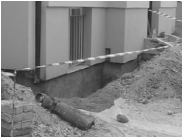
Рис. 8. Отказ работы гидроизоляции из-за неправильно выбранного слоя гидроизоляции
