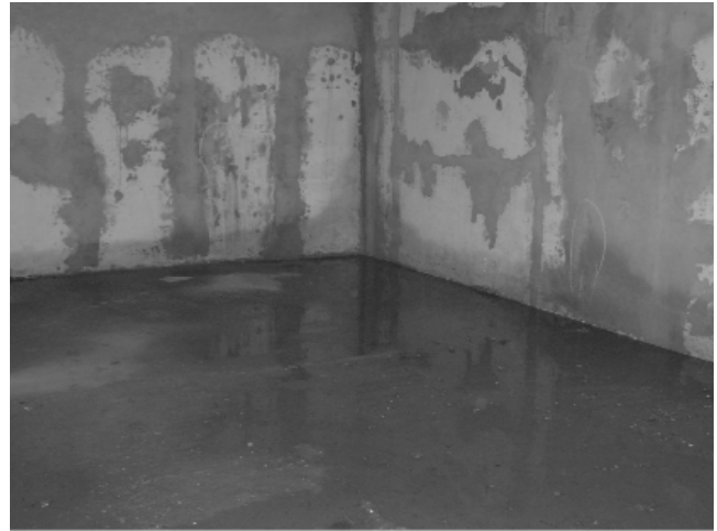
Рис. 3. Отказ работы гидроизоляции в подземных паркингах
