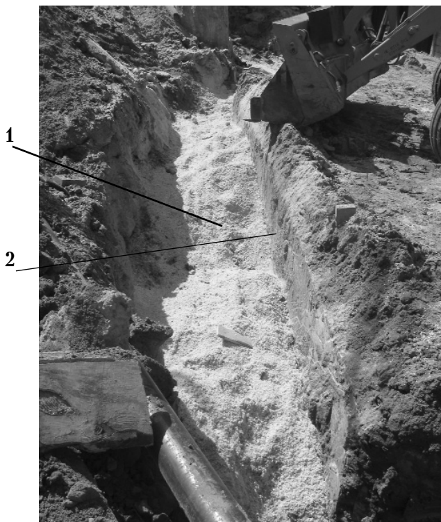
Рис. 6. Розподільна траншея з вібропоглинаючим заповнювачем із дерев'яної тирси: 1 – дерев'яна тирса; 2 – ростверк фундаменту освітлювальної опори.
