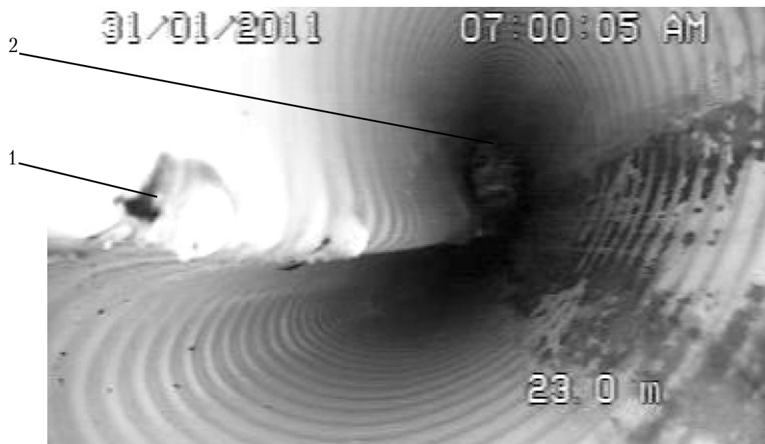
Рис. 10. Зминання труби \varnothing 160 мм, що проходить у футлярі: 1 – труба; 2 – пробка
